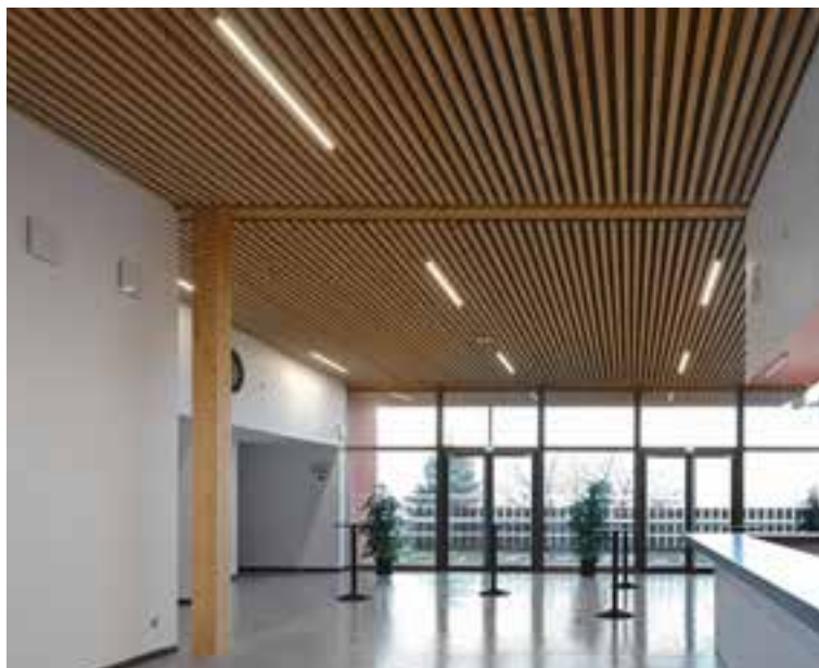
Exemple de plafond acoustique en lames de bois : Salle de spectacles à St-Martin-la-Plaine (42) Architecte : Atelier des Vergers
